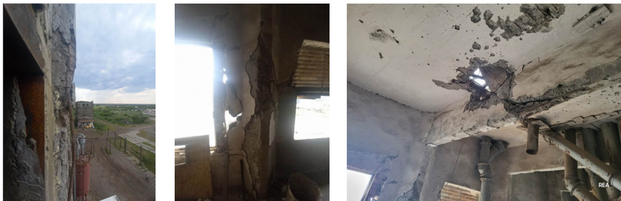
Рис. 1. Характер пошкоджень колони та міжповерхового перекриття
