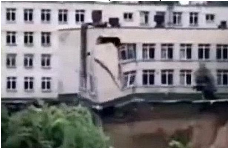
Рис. 8. Руйнування лівого крила будівлі школи
