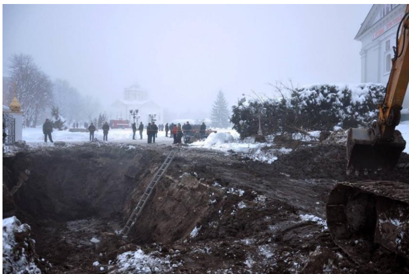
Рис. 28. Прорив каналізаційного колектора у м. Прилуки
