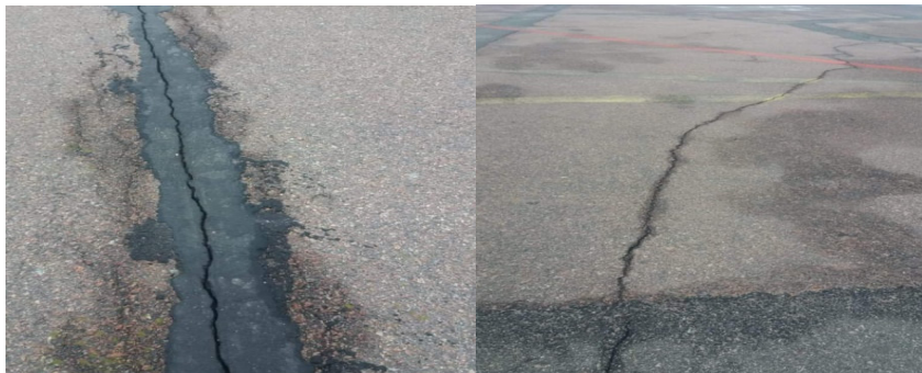
Рис. 3.14. Дефекти асфальтобетонного аеродромного покриття
