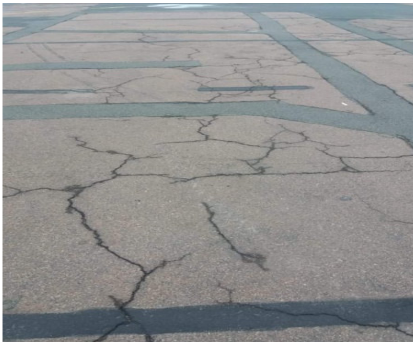
Рис. 3.15. Сітка тріщин асфальтобетонного покриття
