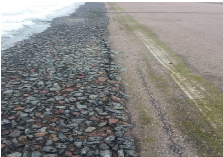
Рис. 3.16. Дефекты щебеневого виmoщення асфальтобетонного аеродромного покриття
