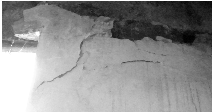
Рис. 4. Руйнування зовнішньої стіни під впливом тривалої дії води
