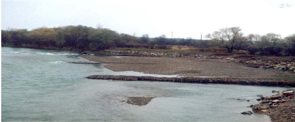
Рис. 2. Система низьких затоплюваних напівзагат на увігнутому березі карпатської річки для боротьби зі звальними течіями і розмивами.
