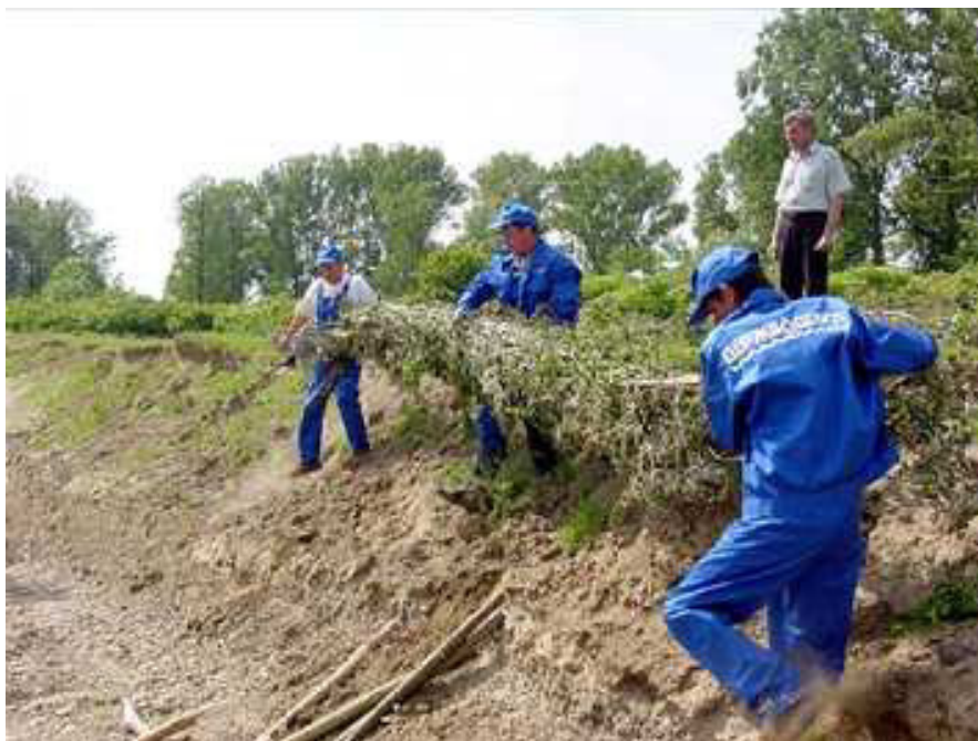
Рис. 2. Виконання робіт з біологічного кріплення берегу р.Тиса поблизу с. Дротинці Виноградівського району
