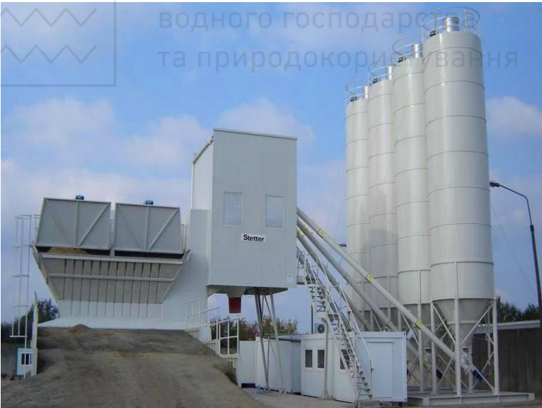
Рис. 4.4. Бетонозмішувальний вузол ТОВ "ЛіхтнерБетон Рівне"
