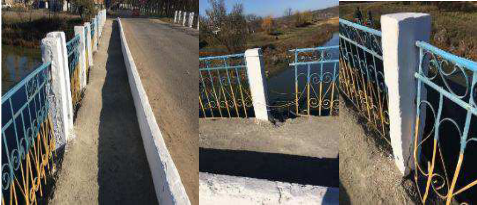
Рис. 4. Поява хвилястості на асфальтовому покритті. Відхилення опор огородження від вертикалі. Механічні пошкодження ґратчастого огороження
