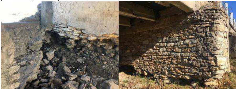
Рис. 3. Руйнація руслових опор мосту на границі коливань сезонної води. Поява тріщин в прогонових будовах моста
