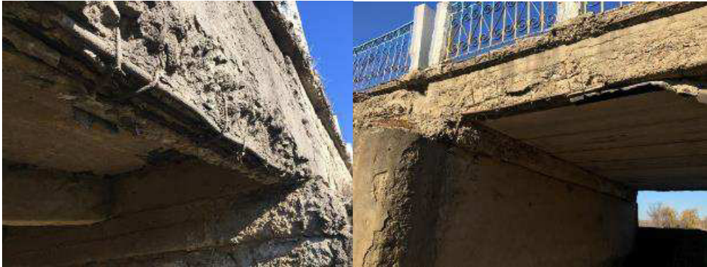
Рис. 2. Пошкодження бетону в стоянях та руслових опорах внаслідок корозії арматури та вітрової ерозії
