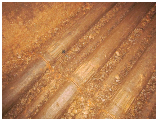
Рис. 4. Фрагмент водозабірної та аераційної системи фільтра
