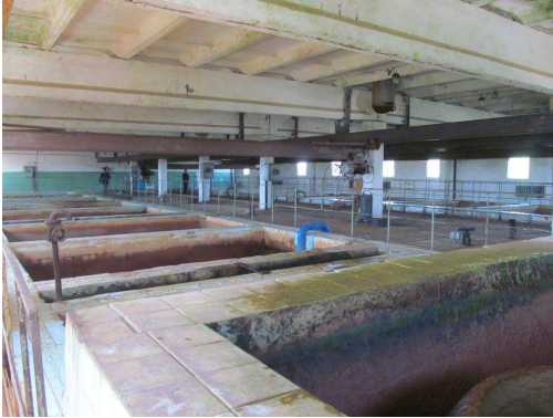
Рис. 1. Фільтрувальна зала водоочисної станції № 1 Горбаківсько-Гориньградського водозабору
