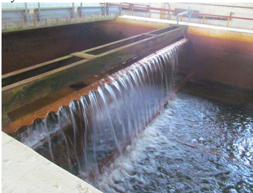
Рис. 3. Аераційний жолоб та фільтр № 3 водоочисної станції № 2
